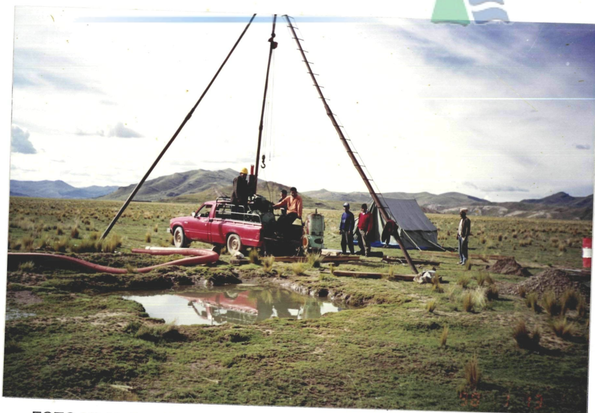
FOTO N° 02 Rehabilitación del pozo, instalación de tubería eductora y líneas de inyección de aire.
