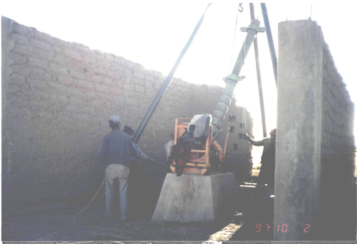
FOTO N° 02 Instalación de equipo de bombeo para el inicio de la prueba de rendimiento a caudal variable.
