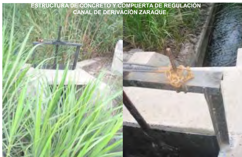
Cuadro N°22: Situación actual de las estructuras de control y medición.
