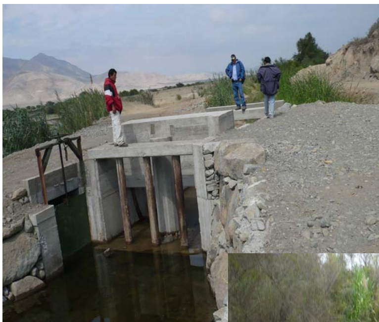
Toma de agua Huaca Larga
