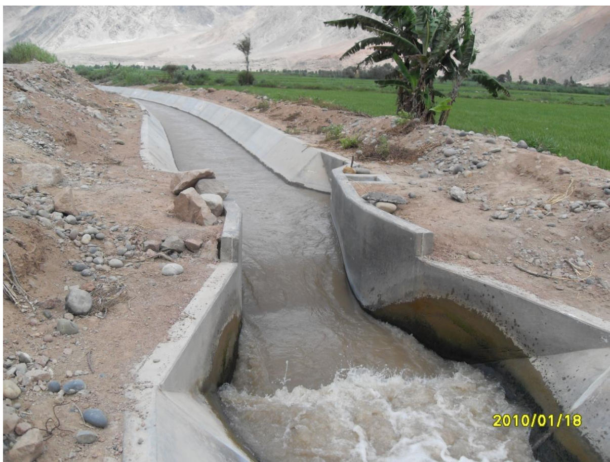
Medidor Parshall – Valle Camaná
